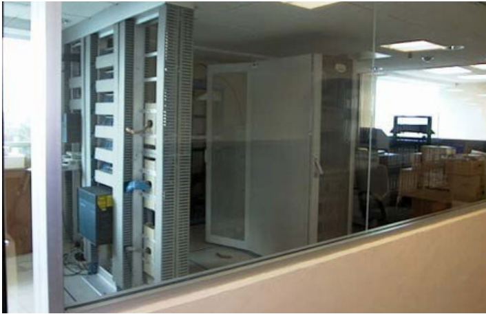
Site de Cómputo - 4to. Nivel
