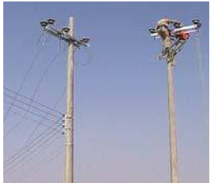
Vestido de Postes - Red de M.T
