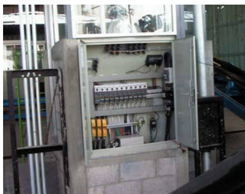
Consola de Control Mezcaldora
