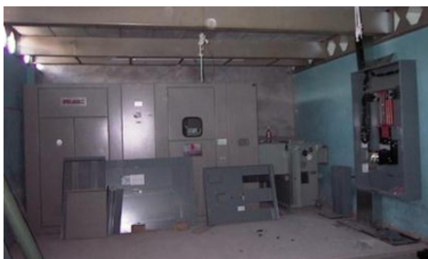
Subestación Eléctrica 300 kVA (en desarrollo)
