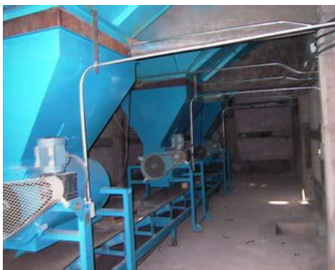
Tolvas - Dosificador de Agregados
