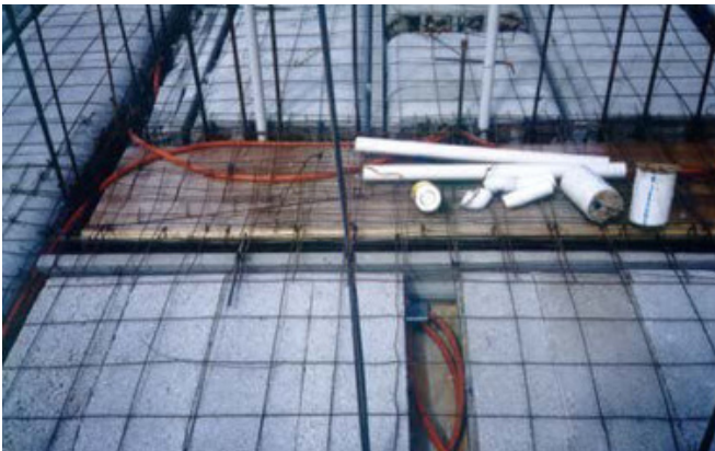
CANALIZACIÓN CIRCUITOS DERIVADOS
