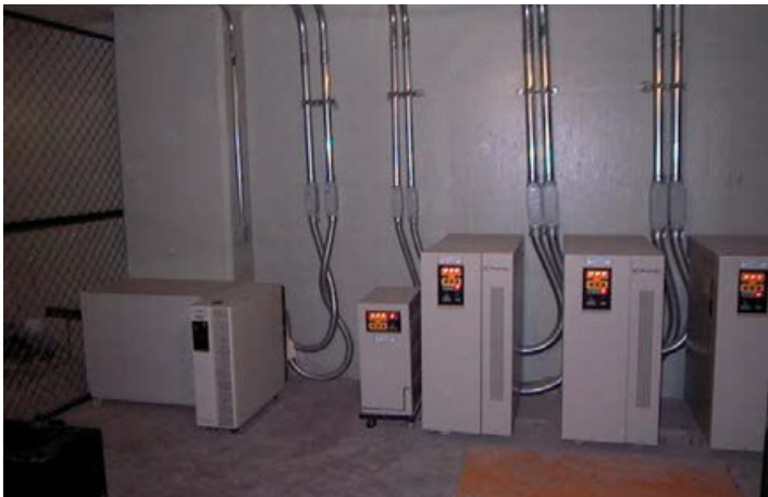
Banco de Reguladores y UPS - Sotano 2
