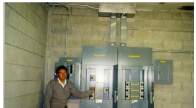
CUARTO DE TABLEROS
