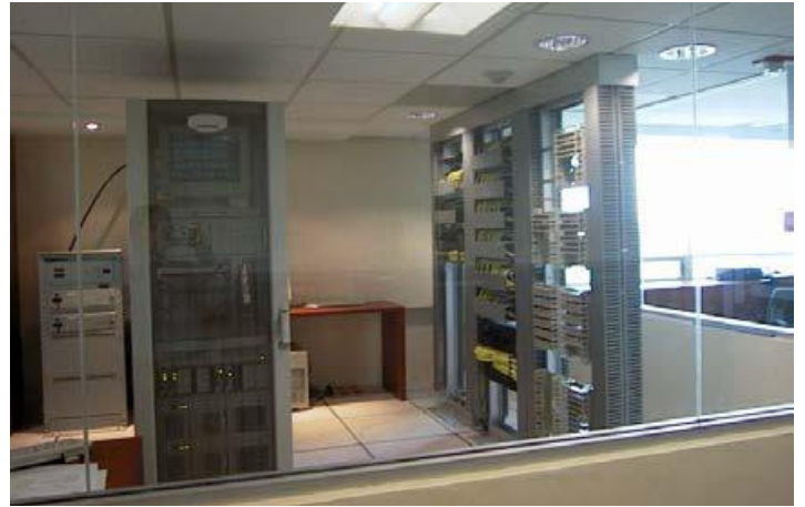
Site de Cómputo - 4to. Nivel
