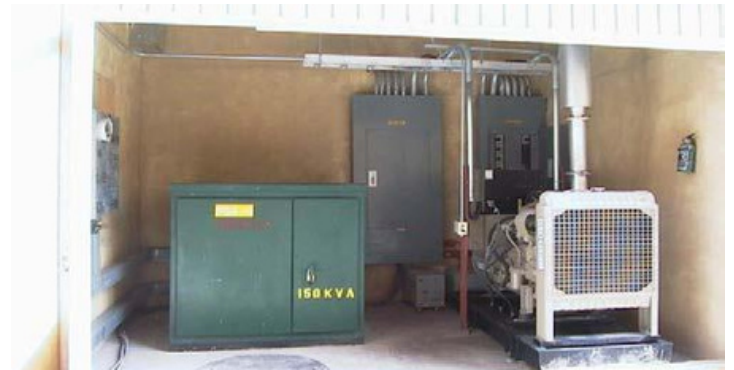
S.E. TIPO PEDESTAL DE 150 KVA Y PLANTA DE EMERGENCIA 60 KW
