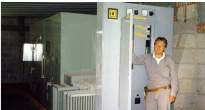
S.E. TIPO DISTRIBUCIÓN DE 300 KVA
