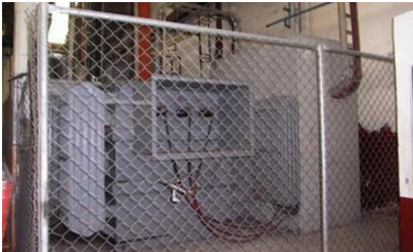
SUBESTACIÓN ELECTRICA - ÁREA FABRICACIÓN ANTES
